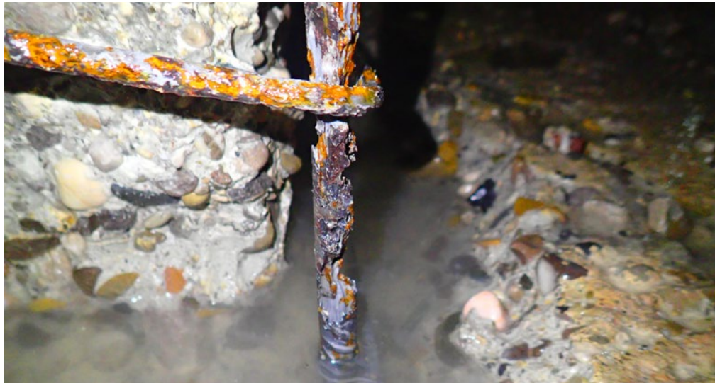
3 Bewehrungskorrosion an einem Stützenfuß infolge Chlorideinwirkung (Quelle: Hochschule München)
